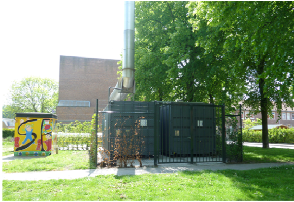
Afb. 8 Naast de aardwarmtecentrale wordt een vergelijkbare ketel geplaatst. Deze ketel zet het gas om in warmte.
